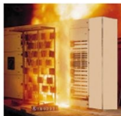
Ensayo de Arco Interno
